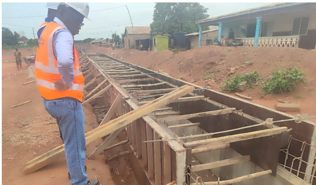
Photo 3 : Caniveaux 120x100 coffrés et non coulés pour manque de ciment
